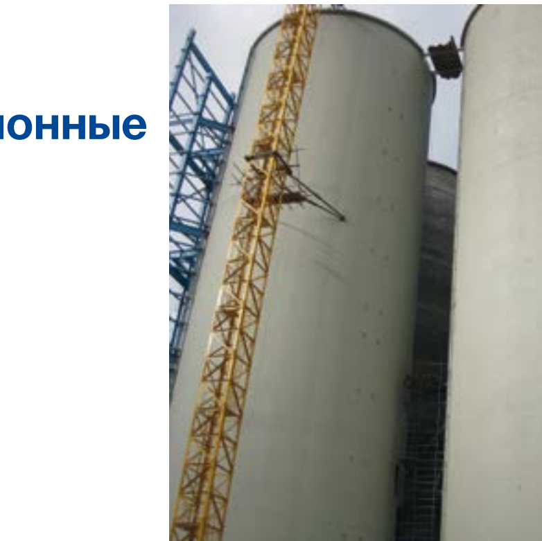
2014 г, Ленинградская обл., г. Сланцы, цементный завод. Силосы хранения сырья. Внешний вид покрытия MasterProtect 320 спустя 5 лет эксплуатации.
