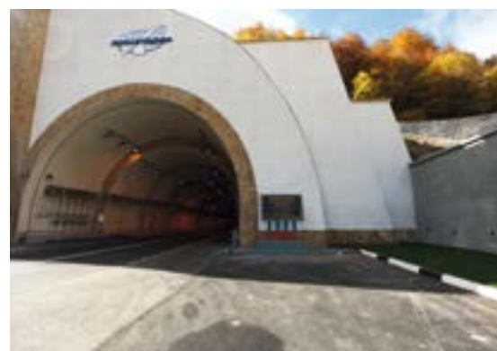
2010 год, р-ка Дагестан. Защита сводов Гимринского Автомобильного Дорожного тоннеля на всем протяжении 4350 м с применением MasterProtect 320 RAL 9010.
