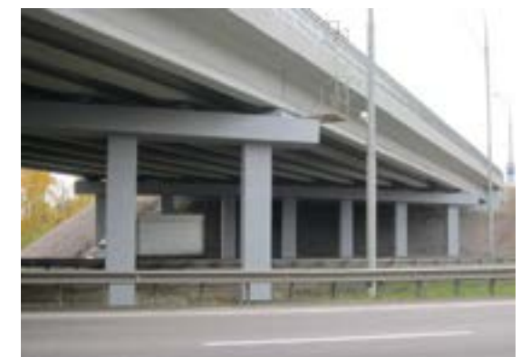
2011 г. Московская область, путепроводы на трассе М5, декоративная защита пролетных конструкций MasterProtect 330 EI RAL 6019, MasterProtect 330 EI RAL 7040 – опор.
