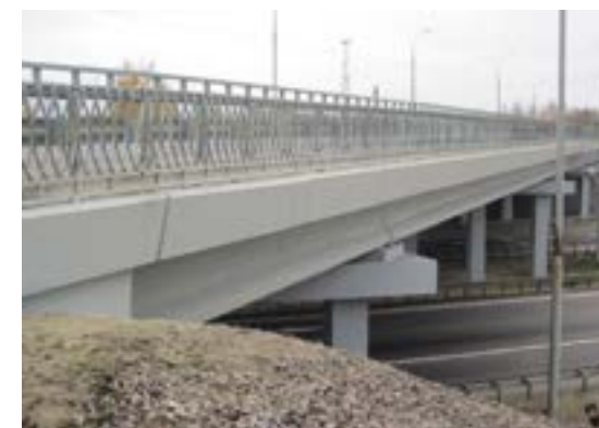
2011 год, Московская область, трасса М4, М5. Текущий ремонт более 20 искусственных сооружений, защита опор и пролетных строений MasterProtect 330 EI RAL 6019 и 7038.
