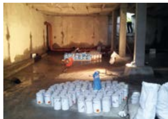
2012 год, Соликамск. Строительство комплекса очистных сооружений. Внутренняя гидроизоляция и химзащита жб резервуаров системой MasterSeal M 336 + P 385.
