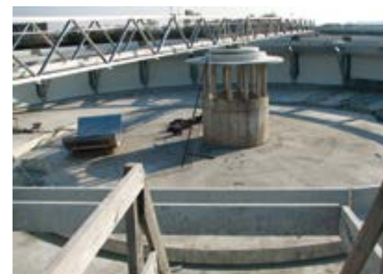
2009–2011 год, Калининград. Строительство городских очистных сооружений. Внутренняя гидроизоляция и защита вторичных и первичных отстойников, аэротенков
